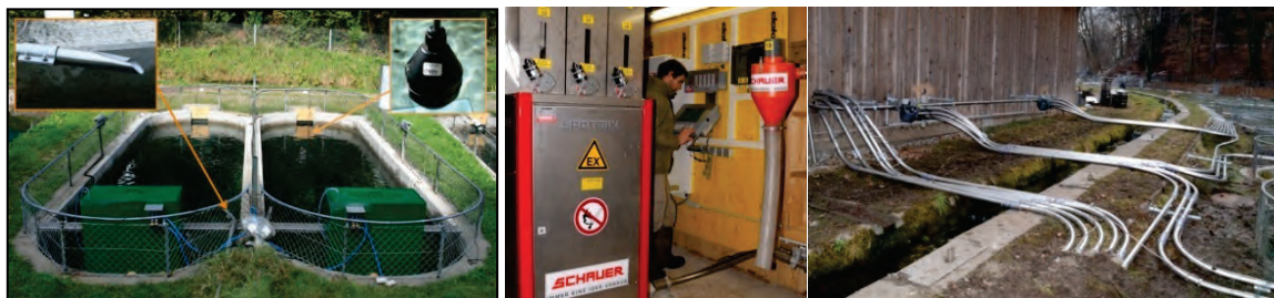
Moderne Technik in der Forellenproduktion: Stromlose Sauerstoffeintragsgeräte mit Sauerstoffmessung und -steuerung (links), Fütterungszentrale (Mitte) und Futterrohre (rechts)
